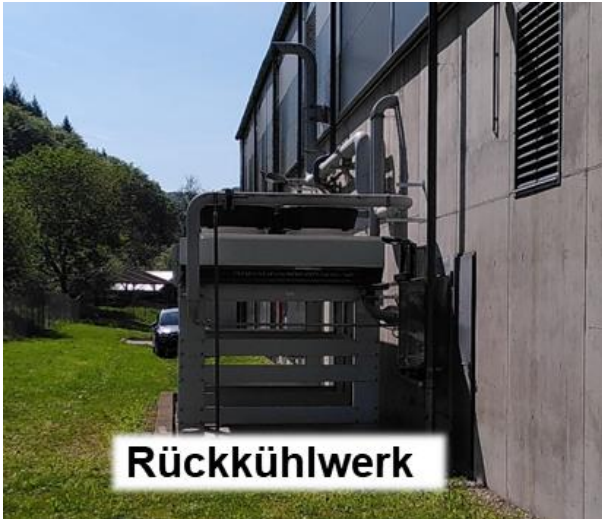
Abb. 29: Rückkühlwerk Biomasse-HKW Kläranlage Ebingen
